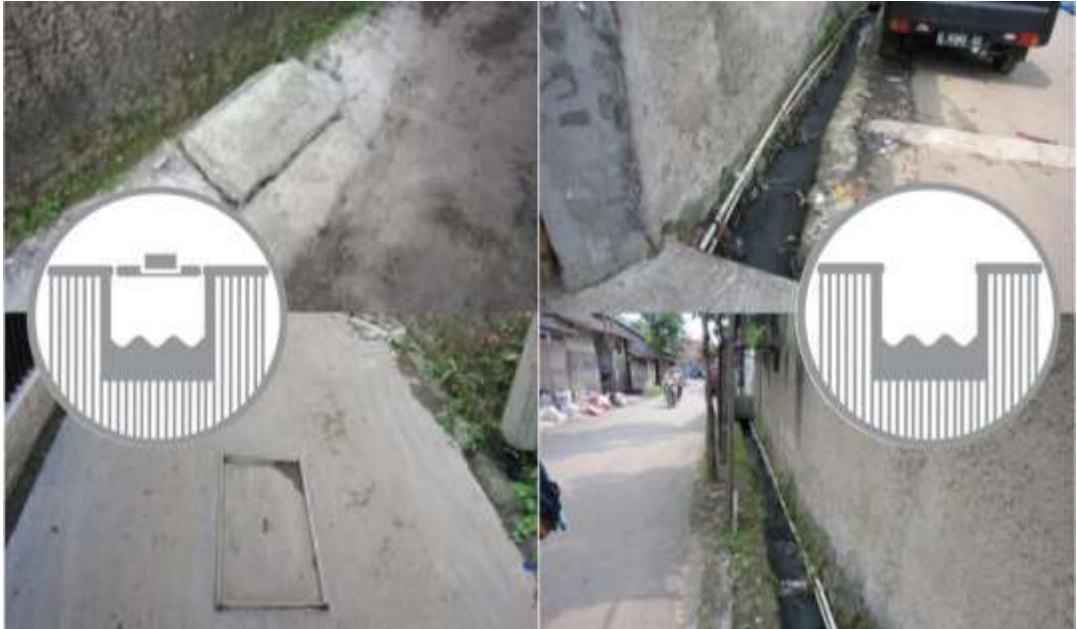
Gambar 11. Kiri: Salurah Air Tertutup, Kanan: Saluran Air Terbuka
