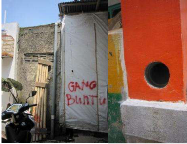
Gambar 21. Pipa Paralon pembuangan air hujan
