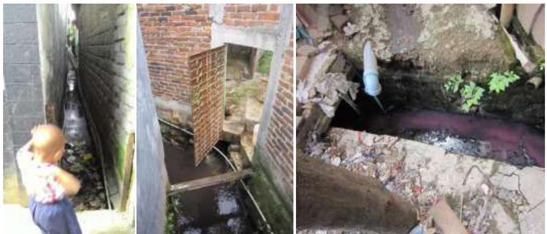
Gambar 20. Kondisi Selokan untuk Air Kotor
