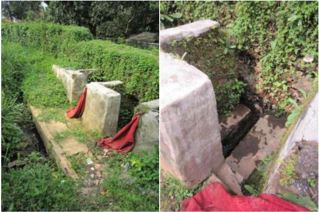
Gambar 19. Kondisi Toilet Umum (c)
