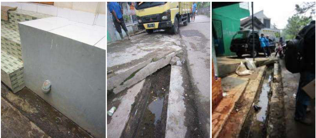
Gambar 12. Kiri: Selokan terlalu dangkal, Tengah: Genangan air, Kanan: Kemiringan tidak teratur
